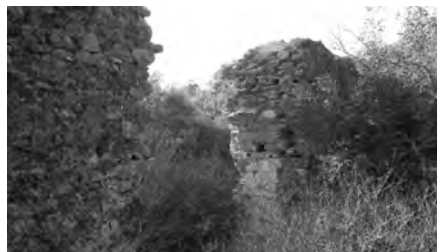
Εικ. 2. Τό κατεστραμμένο τόξο της ύδραγωγού γέφυρας.
