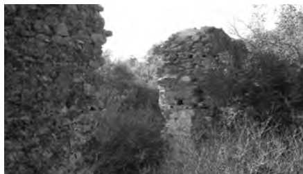
Εικ. 2. Τό κατεστραμμένο τόξο της ύδραγωγού γέφυρας.
