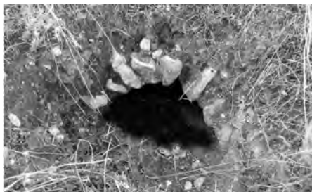
Είκ. 10. Ο κατεστραμμένος υπόγειος υδραγωγός.
