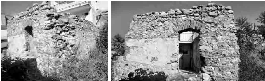
Εικ. 24, 25. Τα μοναδικά υπολείμματα από το Τσαρσί Τζαμί στη ΝΑ γωνία του τζαμιού με το γωνιακό πίσω παράθυρο του μνημείου να διασώζεται σε αρκετά καλή κατάσταση. Το παράθυρο φέρει την κλασική καμπύλη στέψη και η όλη κατασκευή αποτελείται αποκλειστικά από αργολιθοδομή με εγκάρσιες ζώνες οπτόπλινθων και ξυλοδεσιών (φωτ.τ.σ., 2017).
